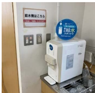
給水スポットの様子
