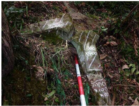
法枠工の浮き
