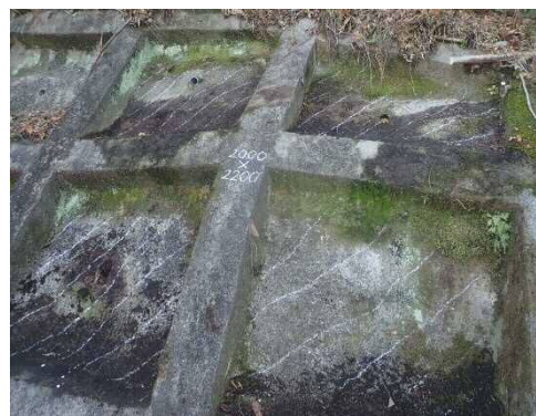
背面空洞の様子
