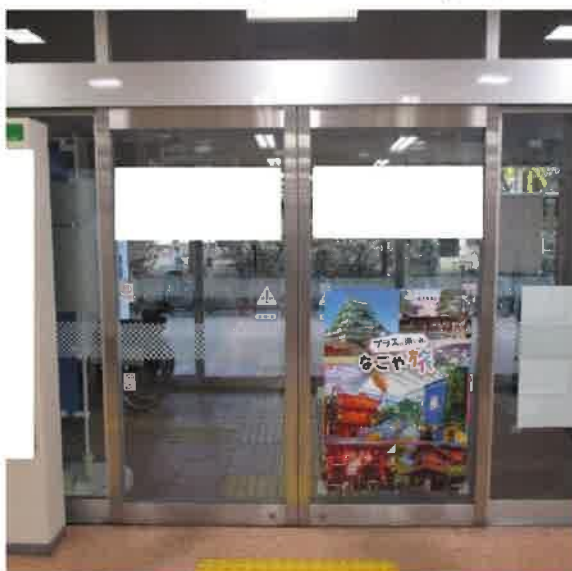
N 1階 庁舎内出入口自動開閉扉上部 扉面
