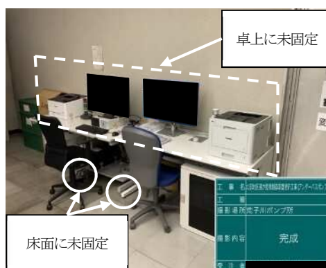
荒子川ポンプ所監視制御装置の状況
