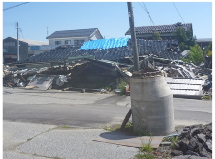
令和6年1月 能登半島大地震 液状化により浮上したマンホール
