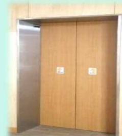
【エレベーター】
