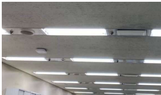
ご利用例：LED 照明への入替
