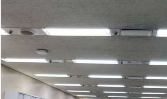
ご利用例：LED 照明への入替
