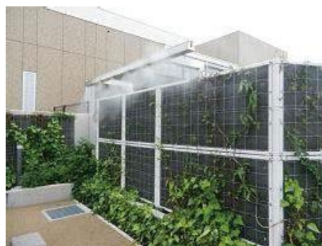
■上下水道局東部営業センター（現千種営業所）に設置したドライ型ミスト
