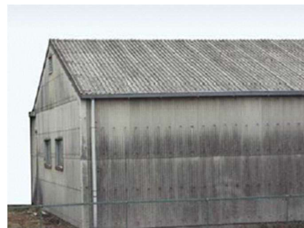
■石綿含有成形板（スレート屋根）
