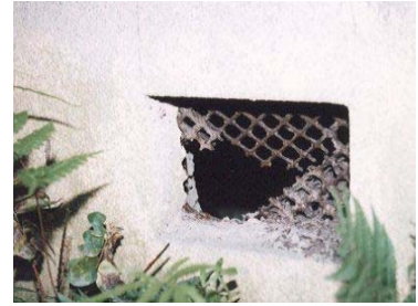
壊れた通風孔
