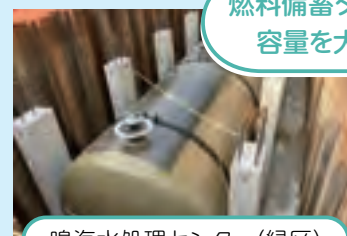
鳴海水処理センター(緑区)
