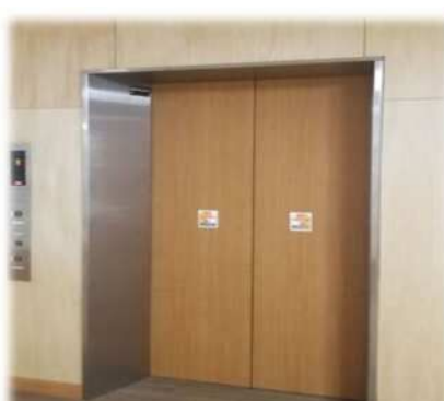
エレベーター
