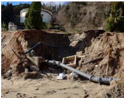
【水道】 浄水場内の土砂崩壊
