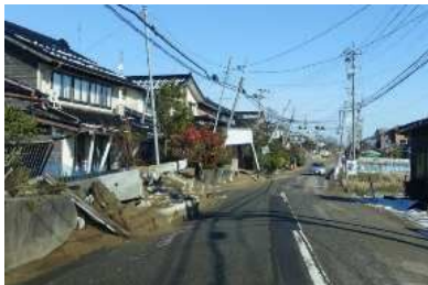
液状化による電柱被害 (かほく市)
