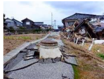
液状化によるマンホールの浮上 (珠洲市)
