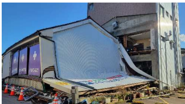
1 階部分が倒壊し潰れた店舗
