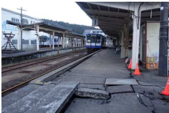
鉄道施設（ホーム）被害 （のと鉄道穴水駅）
