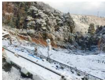
道路崩壊（のと里山海道） （七尾市）
