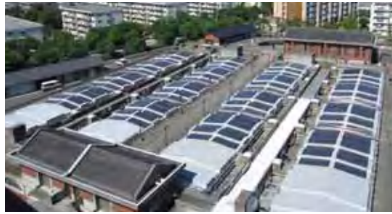
■太陽光発電（鍋屋上野浄水場）
