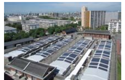
太陽光発電（鍋屋上野浄水場）
