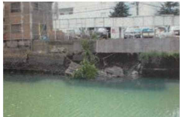
中川区堀川の被災状況
