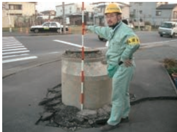
道路の人孔隆起の状況
