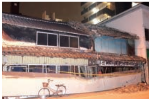
倒壊寸前の古民家
