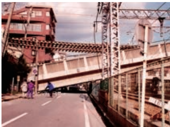
山陽新幹線の阪急今津線交差部の落橋状況
