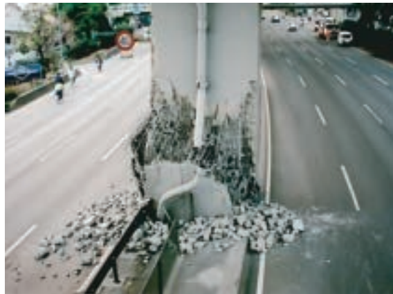
阪神高速道路の橋脚の損傷状況
