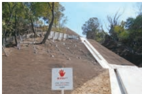
がけ崩れ対策(小幡稲荷公園)
