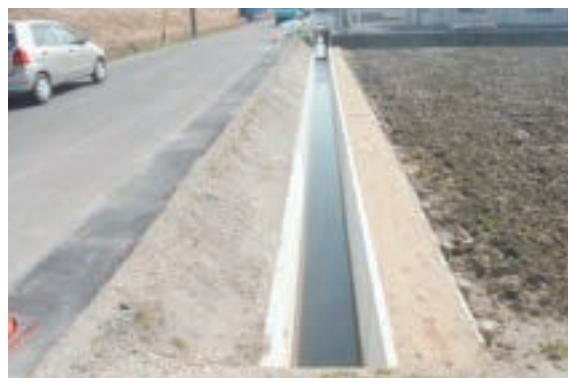
農業用水路(更新後)
