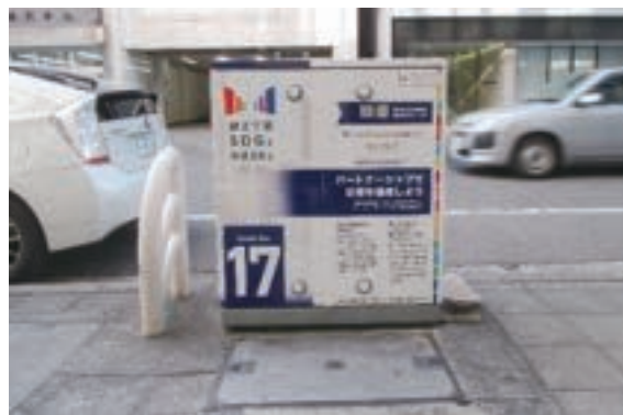
地上変圧器等への広告添加
