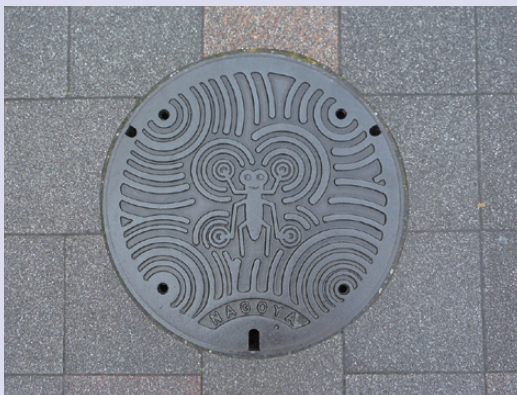
本市の下水道マンホールふた
