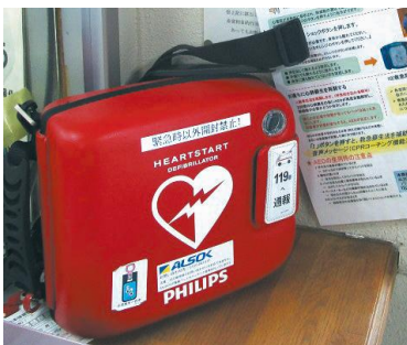
コミュニティセンターに設置してあるAED
