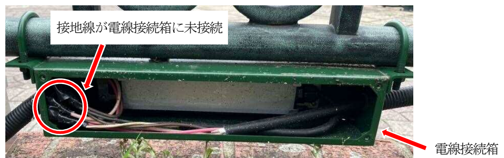
電線接続箱（中間部）の状況
