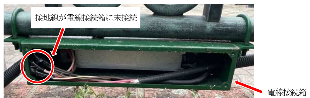
電線接続箱（中間部）の状況
