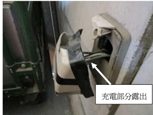
コンセント破損状況
