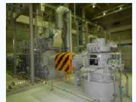
能力増強した雨水ポンプ
