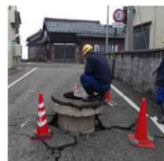
浮上したマンホールの調査
