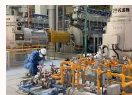
NAWSによる 雨水ポンプ施設の運転管理
