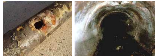
腐食した配水管
