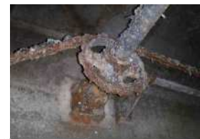
老朽化した下水処理設備
