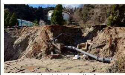
七尾市の浄水場内の配管損傷
