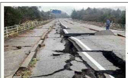
移動途中 七尾市の道路破損
