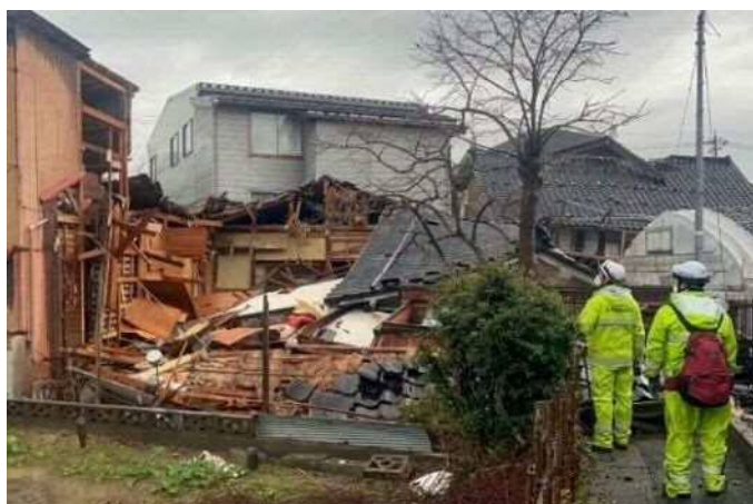
№1 倒壊家屋の状況
