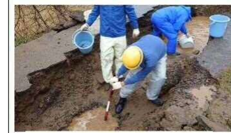
取水口～浄水場の配管損傷を調査
