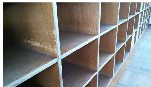
【図 2-2】老朽化した教室のロッカー
