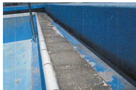
【図 2-8】老朽化したプール水槽
