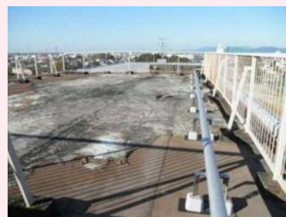
屋上の防水層が劣化 (築 38 年)
