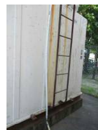
【図 2-12】老朽化した受水槽
