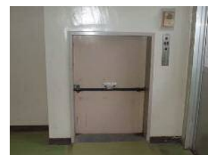
【図 2-13】老朽化した小荷物専用昇降機
