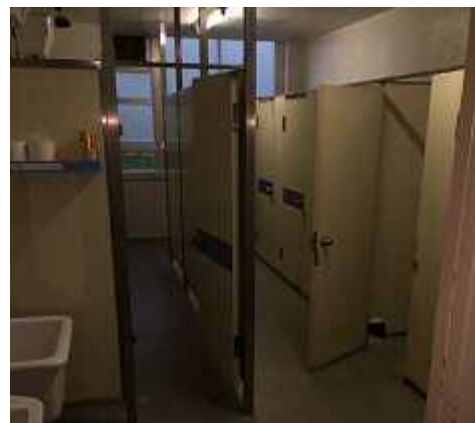
【図 2-5】老朽化したトイレ
