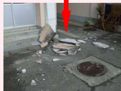
外壁のモルタル片が落下 (築 35 年)
