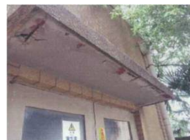
【図 2-10】鉄筋が露出した外壁
