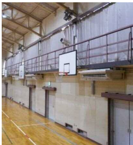
【体育館に設置されている空調設備】
