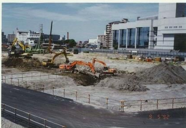
名古屋国際会議場増築工事時地中障害物状況
