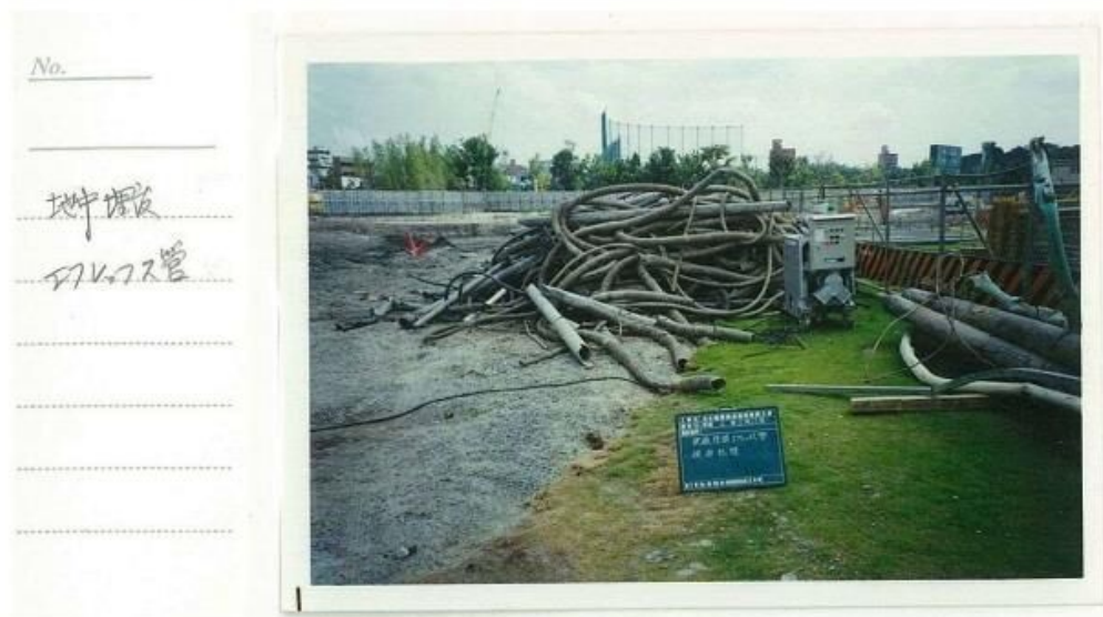
名古屋国際会議場増築工事時地中障害物状況
