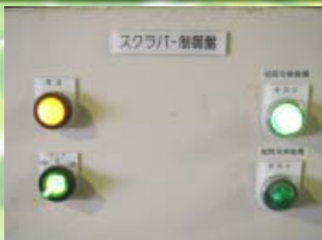
夜間は静音型の排風機を使用
