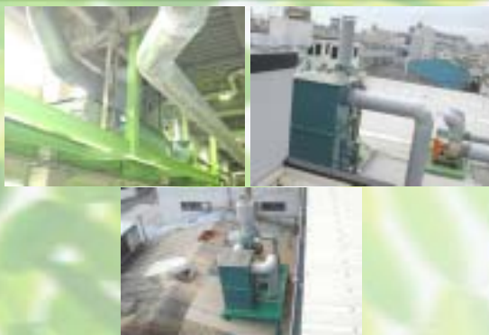
各排風機に浄化設備を設置
