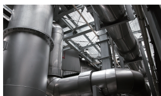
プラント配管
