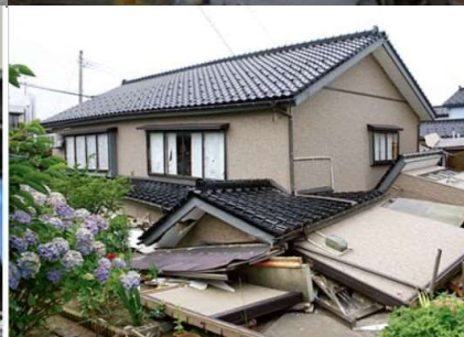
全壊 損害割合 50%以上
