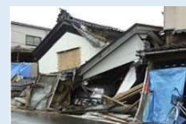
住宅被害の一例
