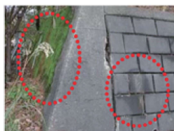
水がしみだしている擁壁
