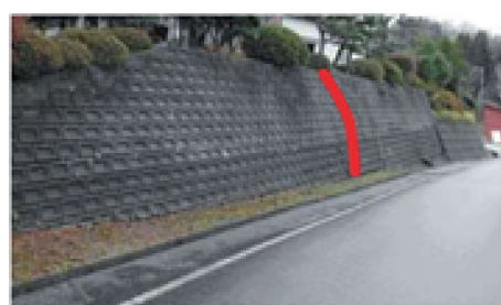
擁壁下端のハラミ出し
