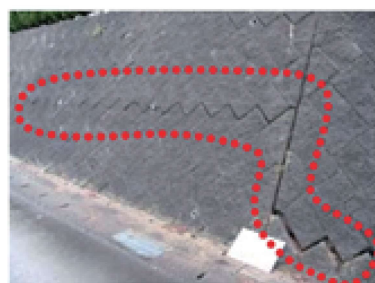
擁壁の長い区間での亀裂
