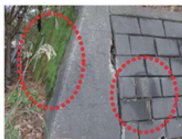
水がしみだしている擁壁
