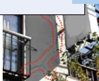
壁面にひびが生じた状態
