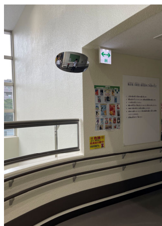
廊下には広角ミラーを設置
