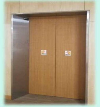
【エレベーター】
