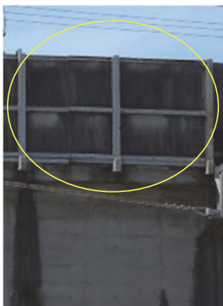
図 1 防音壁の設置状況 (直立防音壁)
