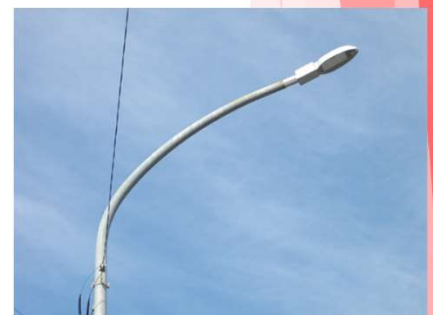
LED道路照明(リース)
