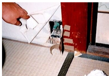
ガス栓付近からの侵入
