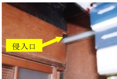
ガス管引き込み口からの侵入
