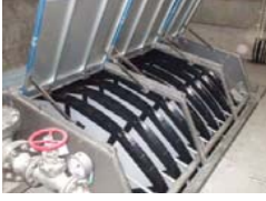
下水高度処理施設（名城水処理センター）
