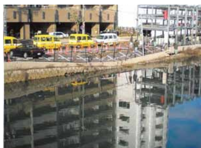
【写真5】老朽化護岸の崩壊
