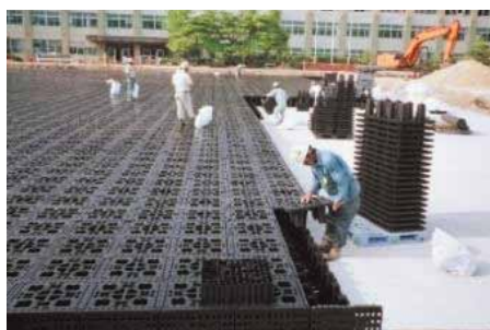
【写真13】校庭に設置された貯留施設
