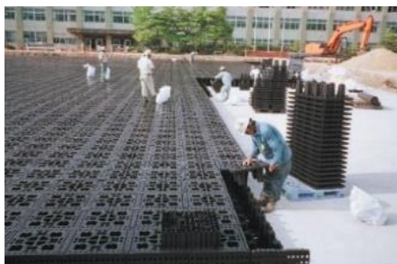
校庭に設置された貯留施設
