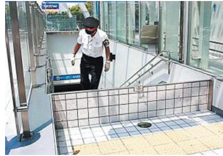
【写真20】地下鉄の起上方式止水板
