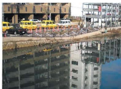
【写真5】老朽化護岸の崩壊
