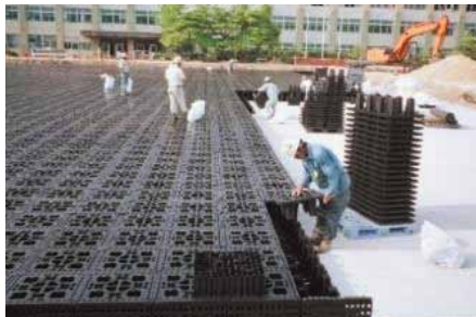
校庭に設置された貯留施設
