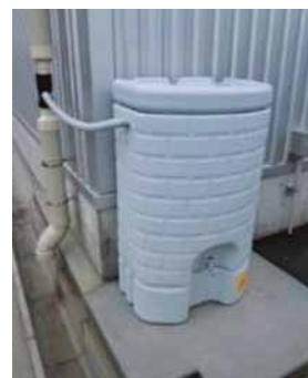
【写真18】雨水タンク
