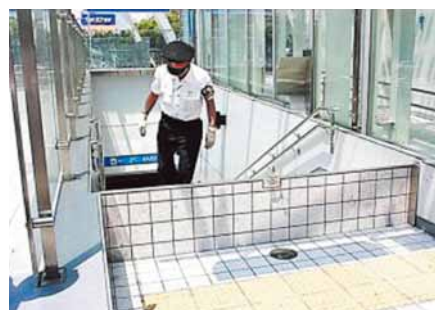
【写真20】地下鉄の起上方式止水板
